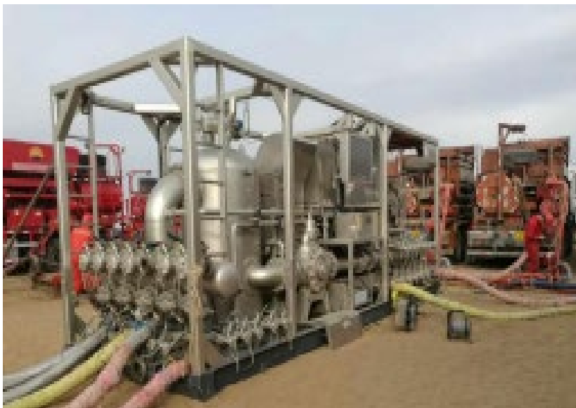
CO 2 增压泵照片
